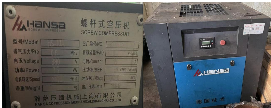
空压机 Air compressor
